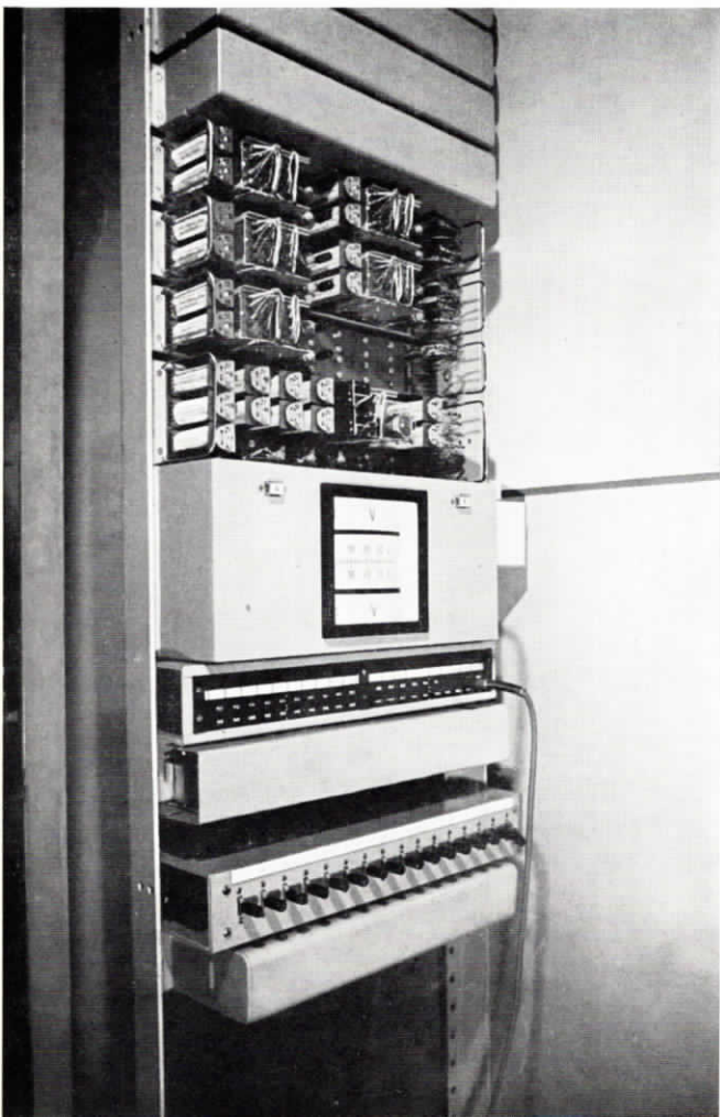
BILD 7 Knotenstelle mit Verstärker und Überwachung in der Verm. Ruhrort, Kästen geöffnet
