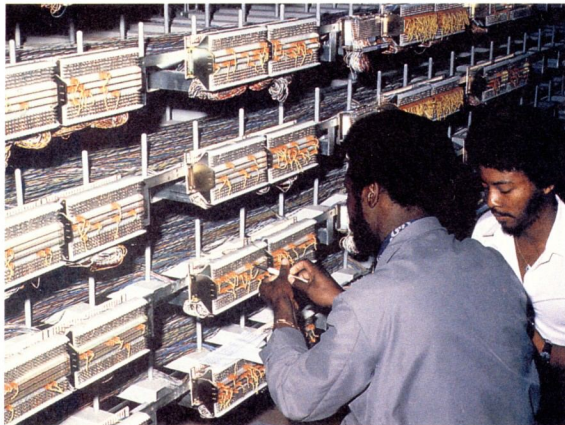
Raccordement des câbles sur têtes horizontales au répartiteur du Pentaconta de Créteil.
