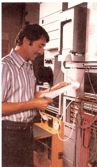
Maintenance dans un central CP400.
