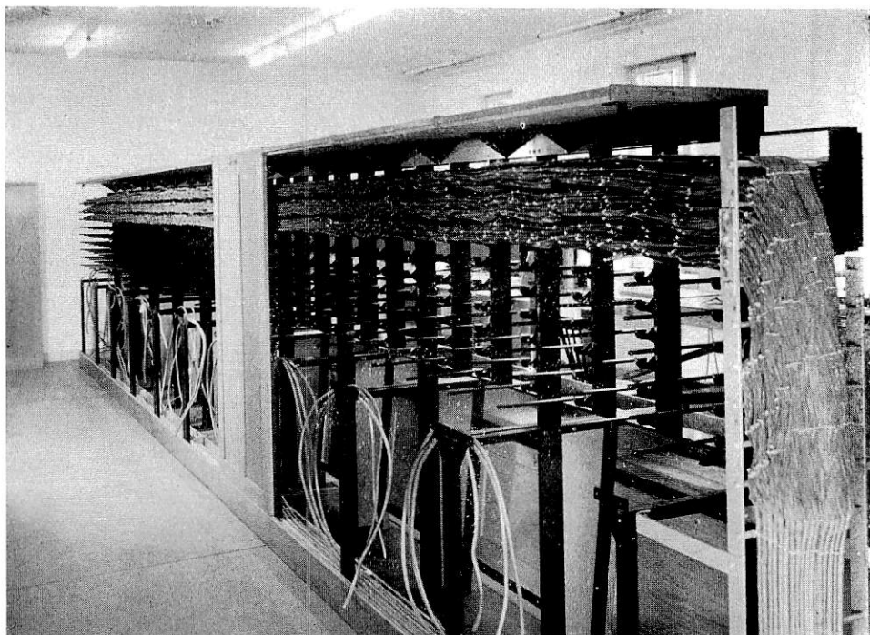
Fig. 65. Nya telefonväxeln vid Stockholm C. Förmedlingsbordets baksida. Bilden tagen under montaget.
