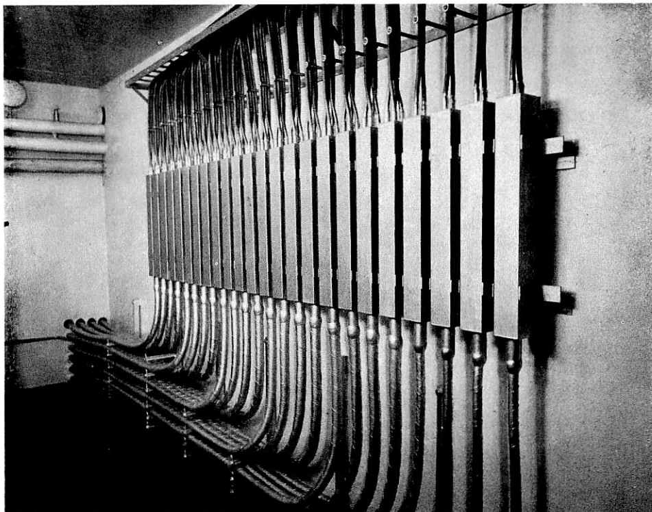
Fig. 77. Nya telefonväxeln vid Stockholm C. Kabelintag.
